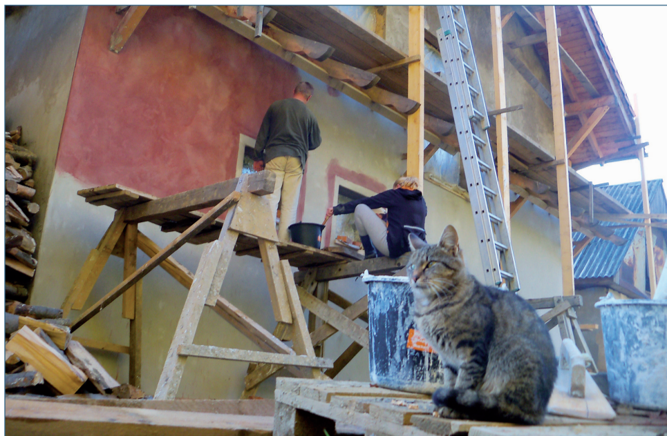
Un crépi de couleur pour la nouvelle maison de Longo maï en Transcarpatie
