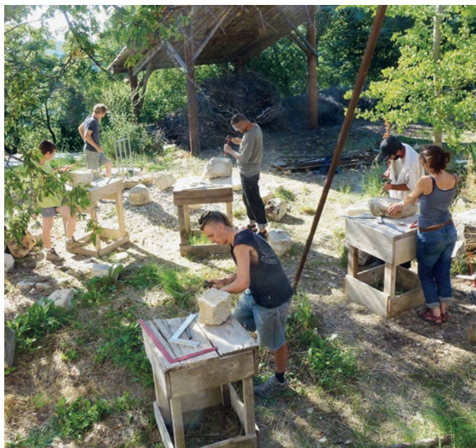
Pour la reconstruction du hameau de St. Hippolyte il faut d'abord tailler les pierres.
