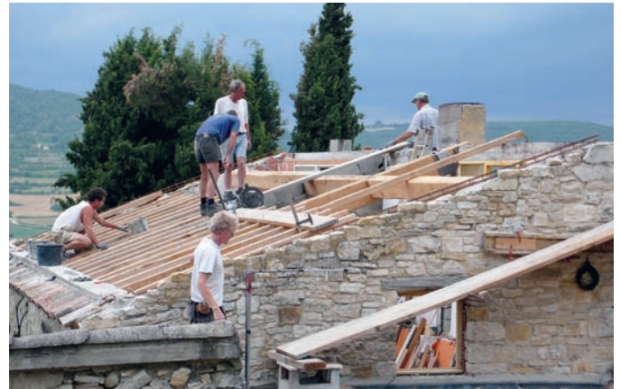
Les chantiers de bâtiment à la coopérative de Limans sont des lieux d'accueil et de formation.
